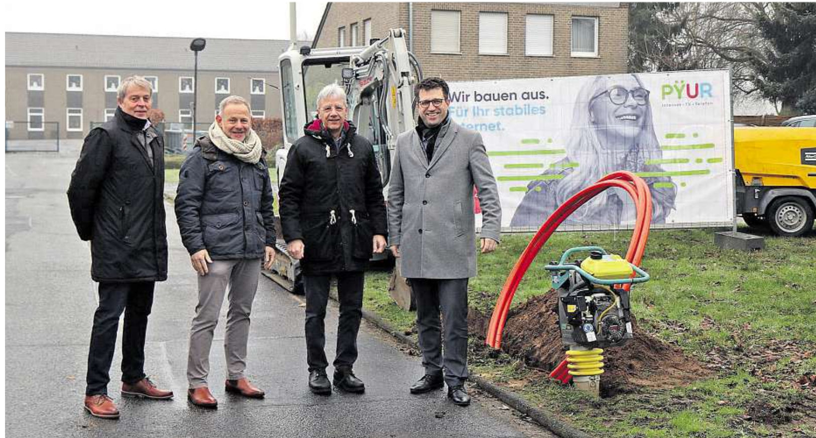
Nettetaler GrundGeorg Diefenthal, Leiter Technik NRW bei der Tele Columbus Gruppe, Mike Spottke, Leiter Mittelstandsvertrieb und Infrastruktur bei der Tele Columbus Gruppe, Rainer Röder, Dezernent für Planen, Bauen und Umwelt des Kreises Viersen, Christian Küsters, Bürgermeister von Nettetal.
