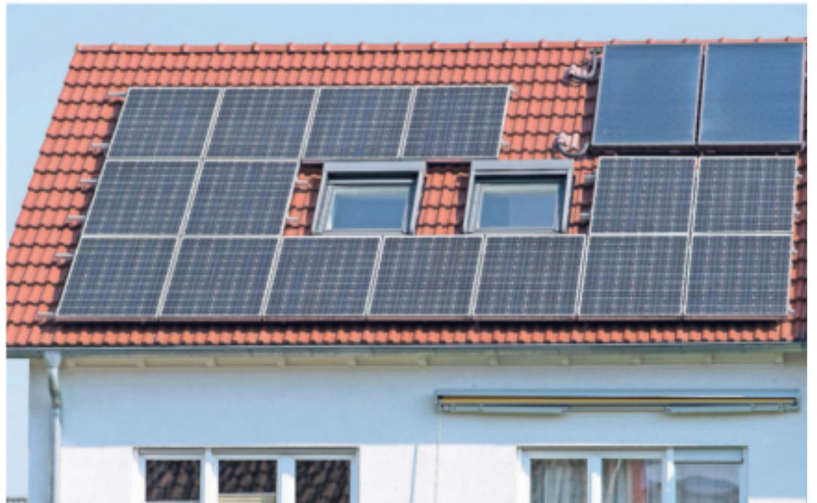
Auch kombinierbar: Solarthermie- und Photovoltaikzellen auf einem Dach.
